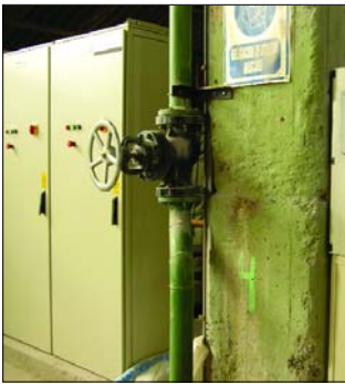
Fritas - PLC de automatización de hornos y "panel view" de comando en campo
