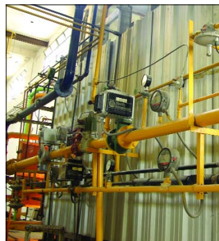
Cañerías de aire y gas. Sistema de combustión y medición de temperatura
