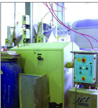
Planta Piloto - línea de esmaltación
